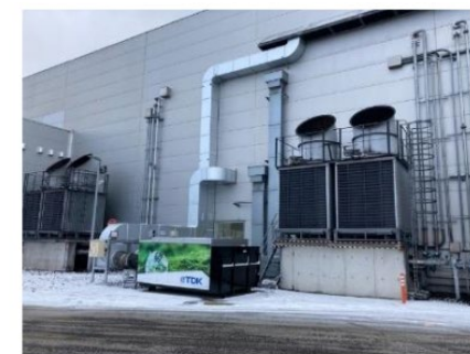
B: 利用場所 外観 (運んだ排熱を利用)
